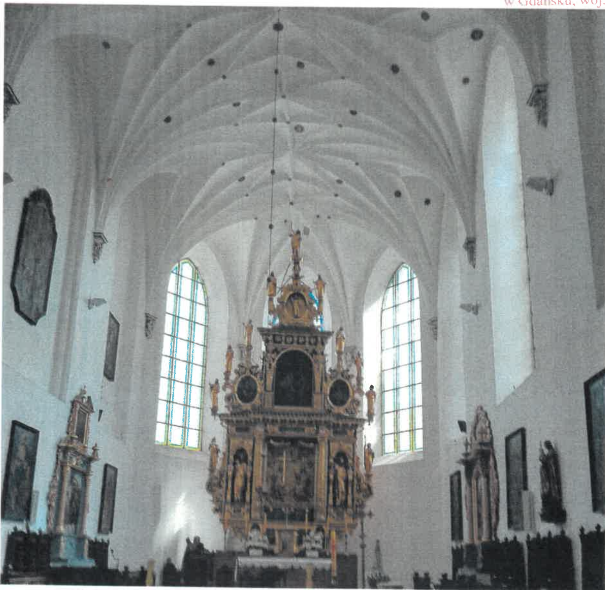
Zdjęcie nr 7 – strop betonowy zdobiony nad prezbiterium kościoła - autor zdjęcia W. Garbacewicz
